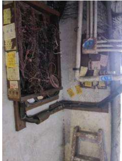
電線、電話線、水管殘舊。
