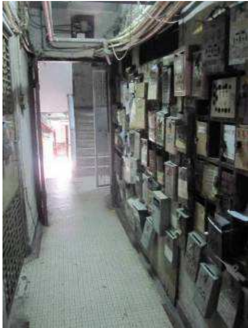
走廊有電線外露，沒有設置防煙門。
