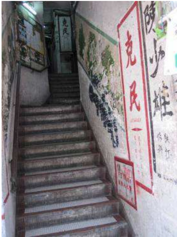
樓梯較為破舊，光線昏暗。
